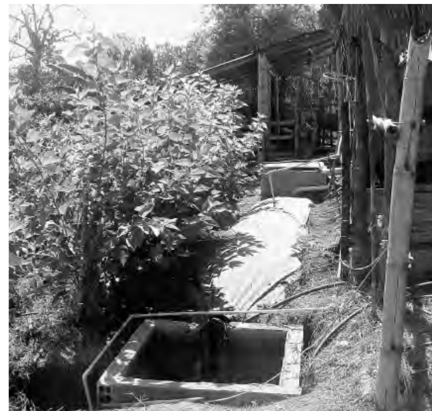
Un biodigesteur fait avec un sac en plastique de 1,2m de diamètre et 6 de long, relié à une porcherie (20 animaux) et protégé par un mûrier. Photo : Lylian Rodriguez
