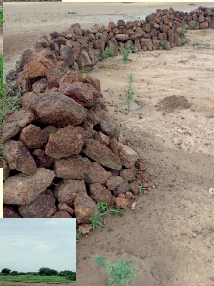
Une rangée de diguettes en pierre (cordons pierreux) pour retenir et conserver l'eau pour récupérer les terres dégradées
